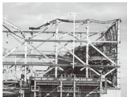
▲ガレキ撤去が待たれる1号機建屋上部
